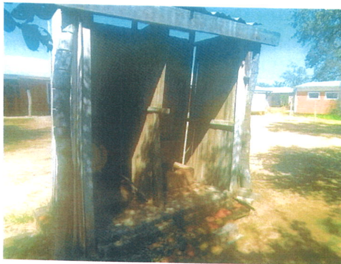
Baños tipo letrina, con graves problemas infraestructura, sin techo y sin puertas.
