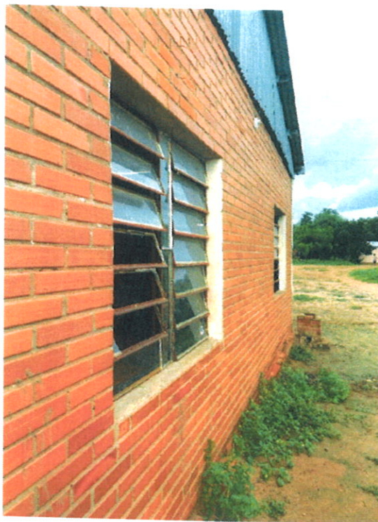
Paredes con grietas y ventanas con vidrios rotos en la Escuela Básica N° 6308 Cesar Romero
